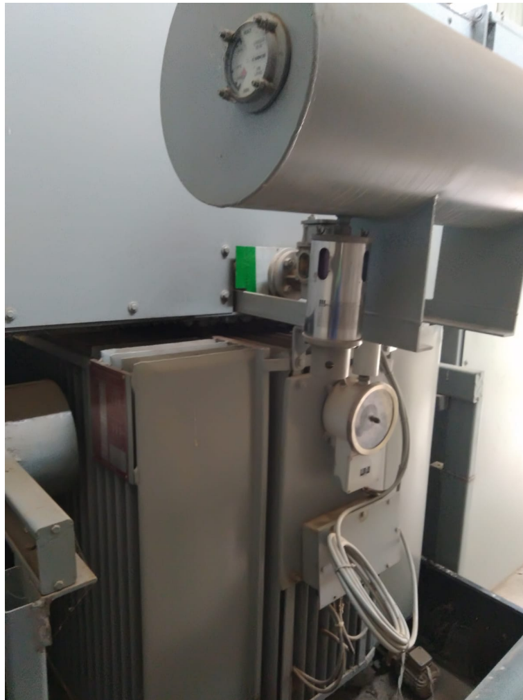
Fotografía N°03: Transformador de Potencia
