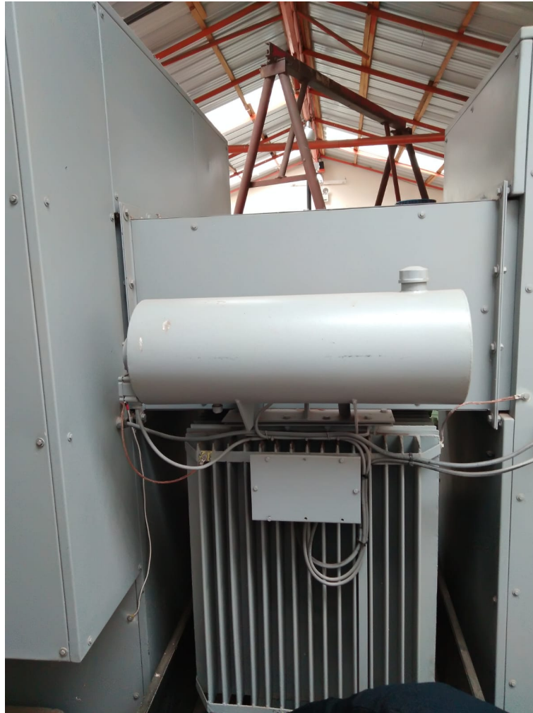
Fotografía N°02: Transformador de Potencia
