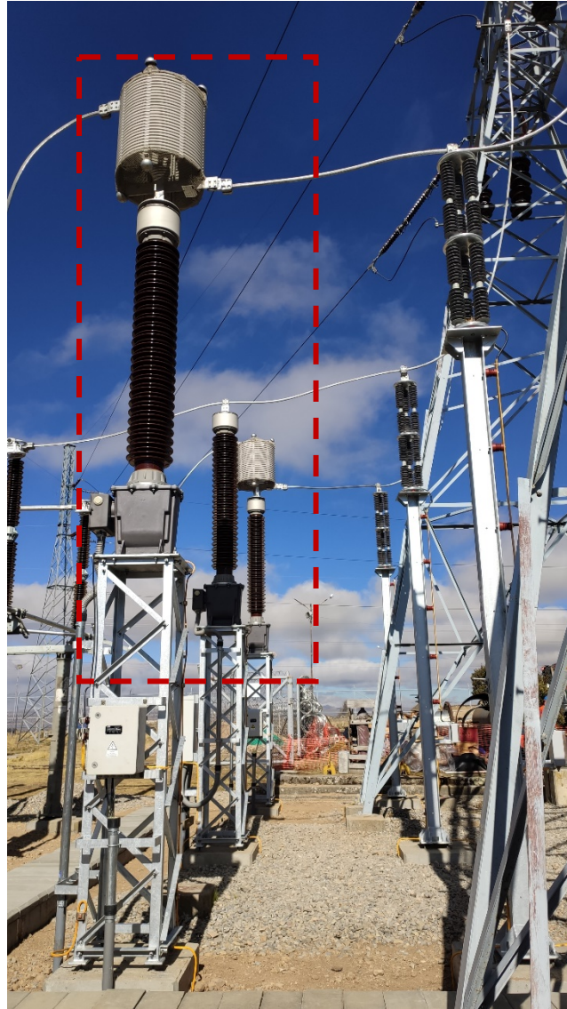
Fotografía N°04: Transformadores de Tensión
