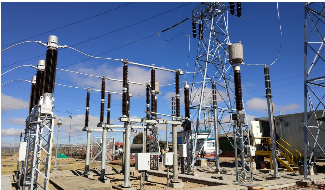
Fotografía N° 03: Vista Panorámica – Bahía 138 kV (CL-1703)
