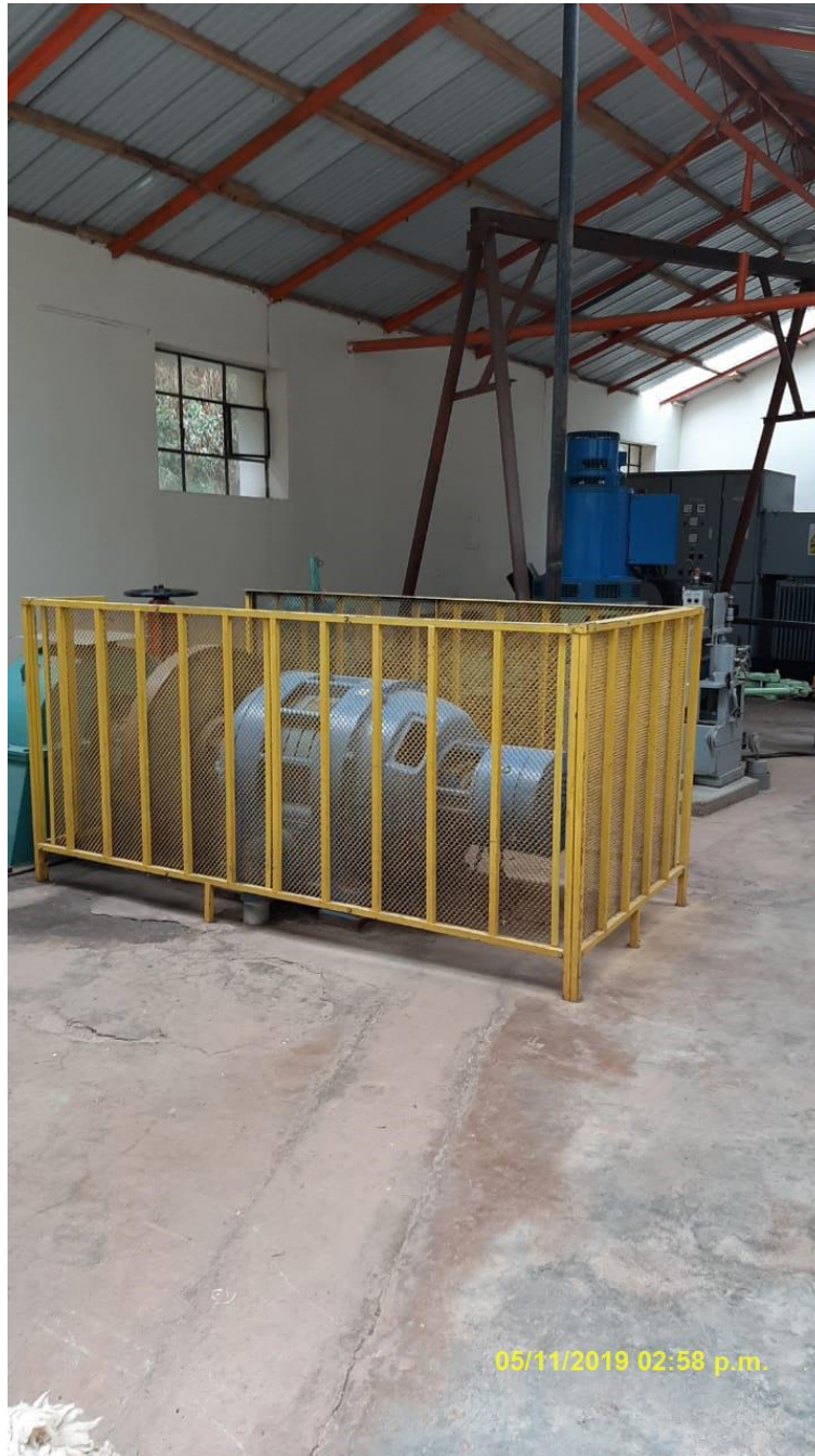
Fotografía N°01: Casa de Máquinas: Grupos de Generación
